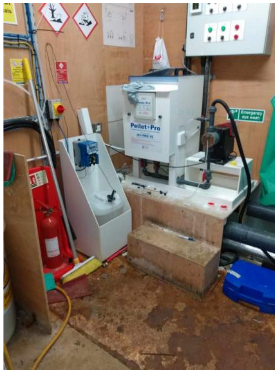
72) Filtration unit interior
