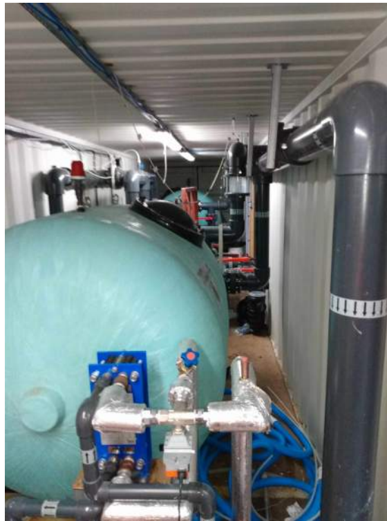
73) Filtration unit interior
