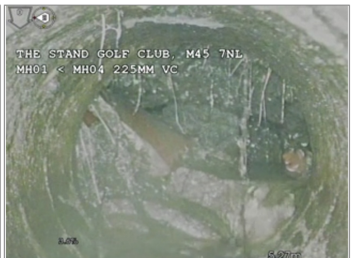
Survey abandoned - Remark: SA DUE TO COLLAPSED DRAIN.
