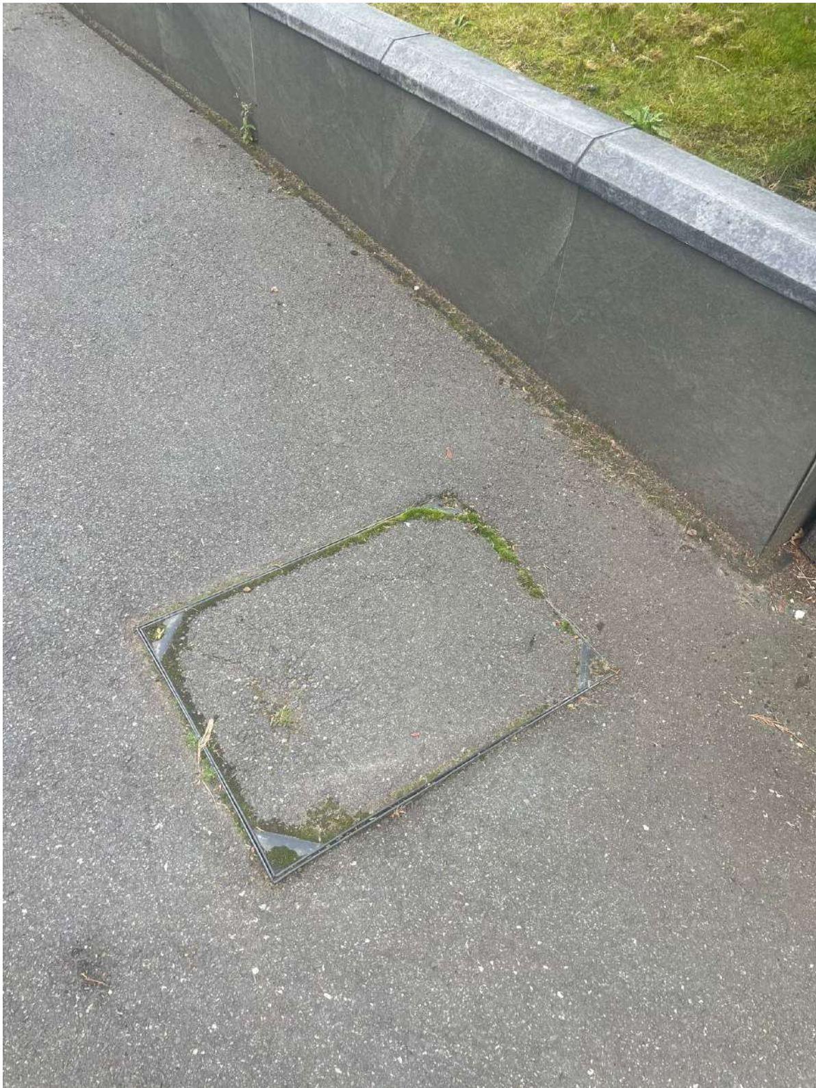
Manhole - MH01 (LID)
